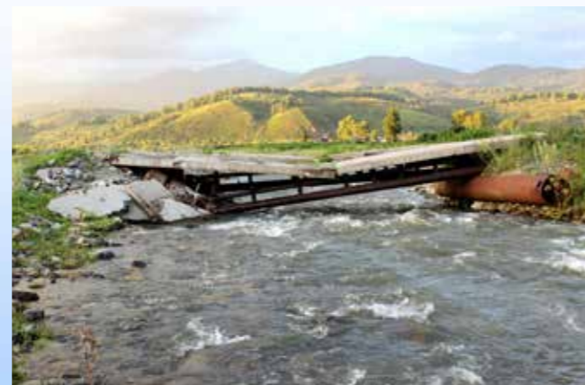
Рисунок 12. Разрушенный мост на речке Быструха
